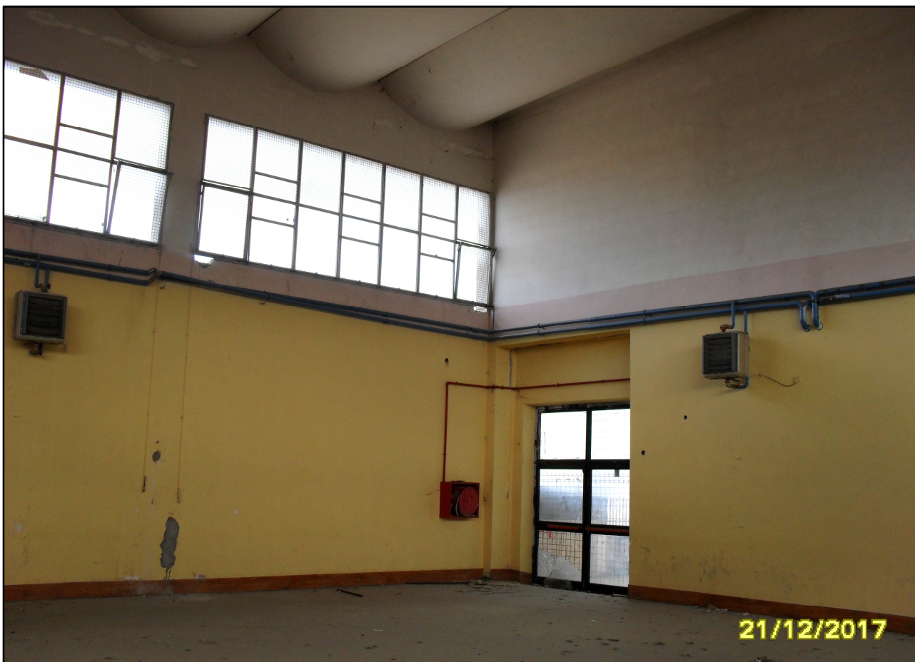
Foto n. 4: vista interna della palestra verso la porta di accesso su via G. Carducci.
